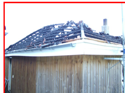
Den ødelagte garage, efter branden
