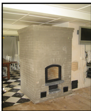
Masseovnen set fra forsiden med optændingskammeret.
